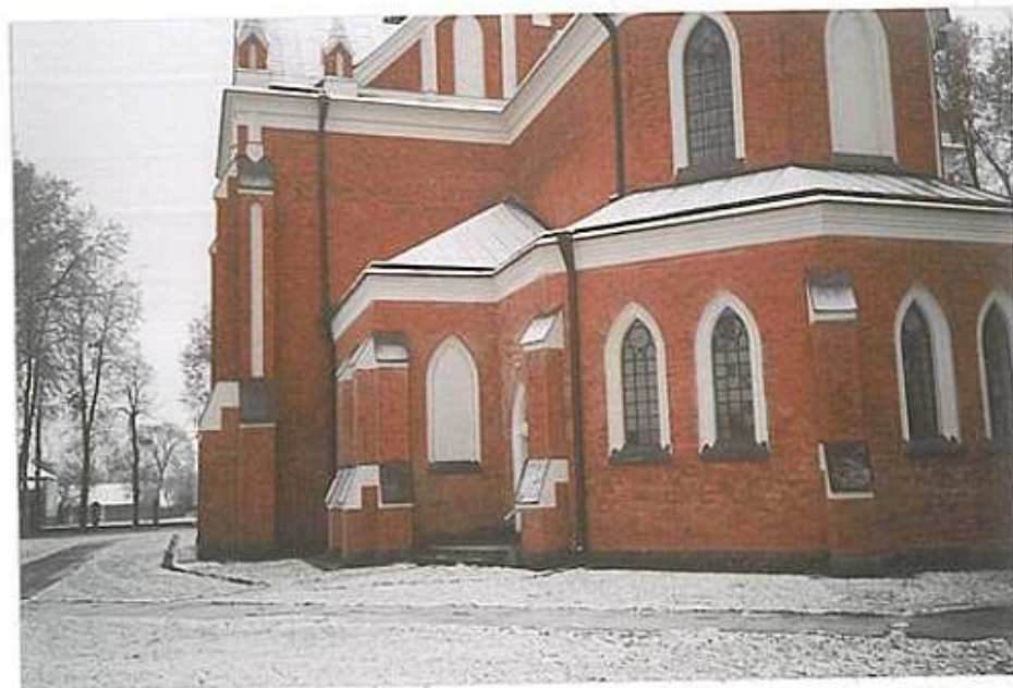
PO NAPRAWIE TYNKÓW. STRONA PÓŁNOCNA.
